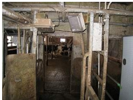
写真7 機器設置状況 (A 牧場)
