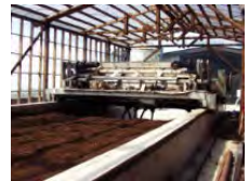
良質な堆肥を供給する堆肥処理施設等
